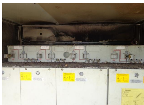
Gambar 3 Gardu kios dengan peralatan pemindahan menggunakan ring main unit
