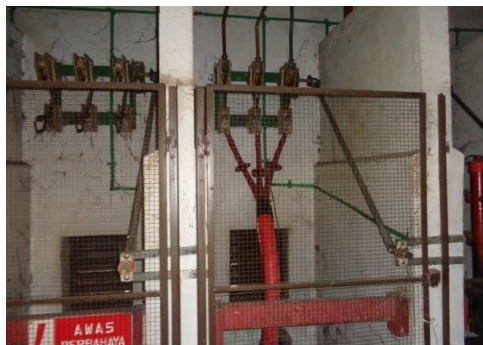
Gambar 2 Gardu beton tipe open cell dengan peralatan pemindahan menggunakan disconnecting switch
