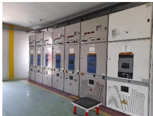
Gambar 1. Ruang Kubikel 20 kV
